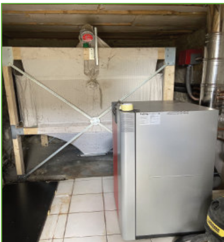
Programme Habiter Mieux : aide à l'installation d'une chaudière à granulés avec silo.
